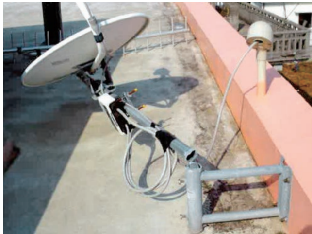
台風で根元から折れたアンテナ
