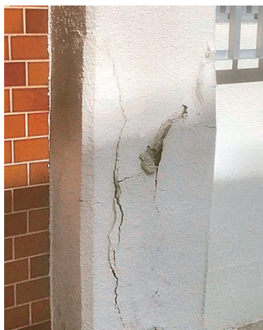
コンクリートのひび
