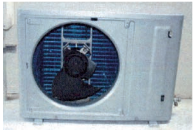
強風によりファン・モーターが破損
