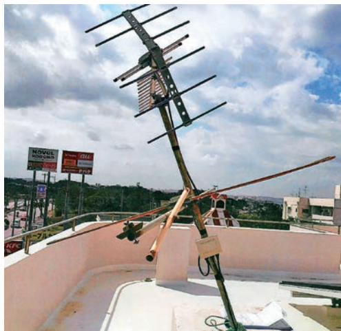
台風で傾いたアンテナ
