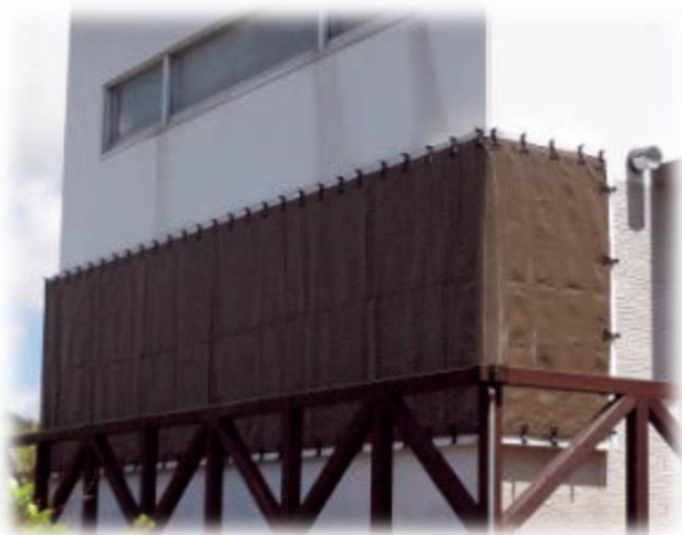
窓ガラスに設置されたハリケーン・ファブリックの様子
