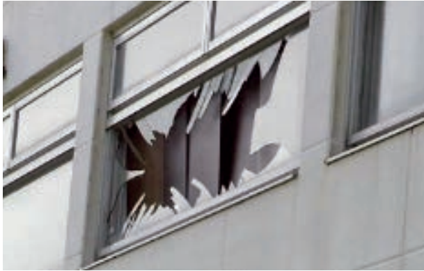
割れたガラス
