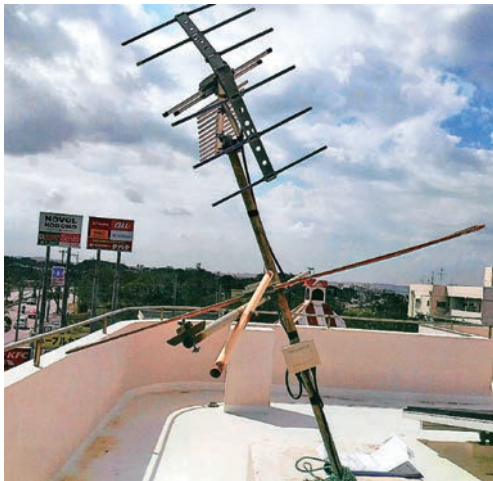
台風で傾いたアンテナ
