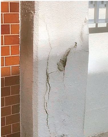
コンクリートのひび
