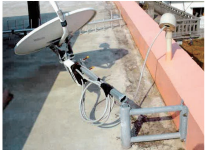
台風で根元から折れたアンテナ
