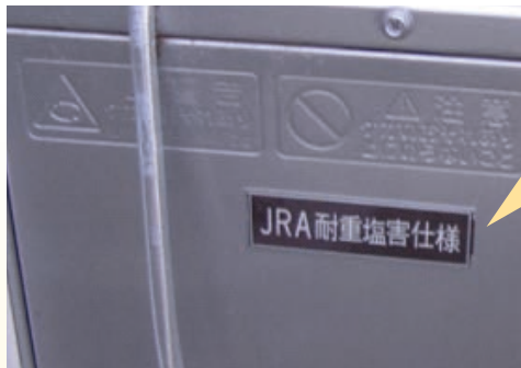
耐塩害仕様の室外機
