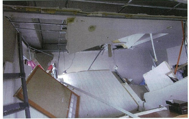
室内に風雨が吹き込み大きな被害が発生する
