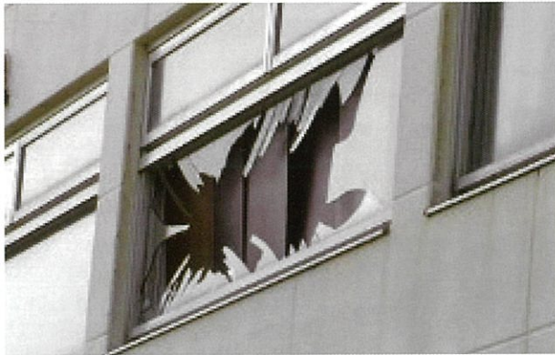
割れたガラス
